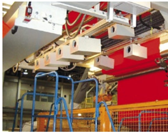
Der Einsatzort des Shelton WebSpector Systems innerhalb der Textilproduktion unterliegt nicht den Beschränkungen einer manuellen Prüfung
