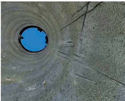
Gerendertes 3D-Modell eines Betonrohrs inklusive Beschädigungen
