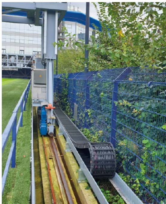
Die Energie- und Datenleitungen folgen den Bewegungen des Hauptträgers über eine Strecke von 120 Metern – eingelegt in rollende Energieketten von Igus.
