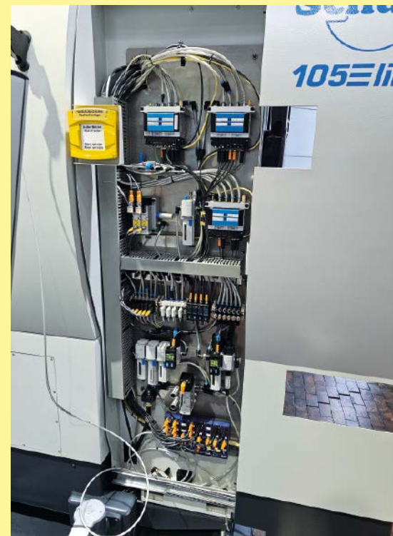
In den Maschinenkörpern der Schleifmaschinen von Schütte wird die komplette Anbindung der Peripherie über AS-Interface realisiert.
